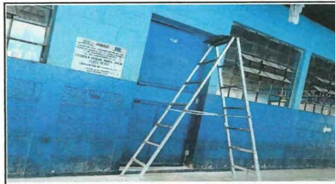
Puerta que necesita mantenimiento y cambio de abatimiento
