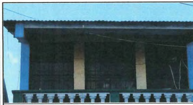
Láminas deteriorada de la Dirección
